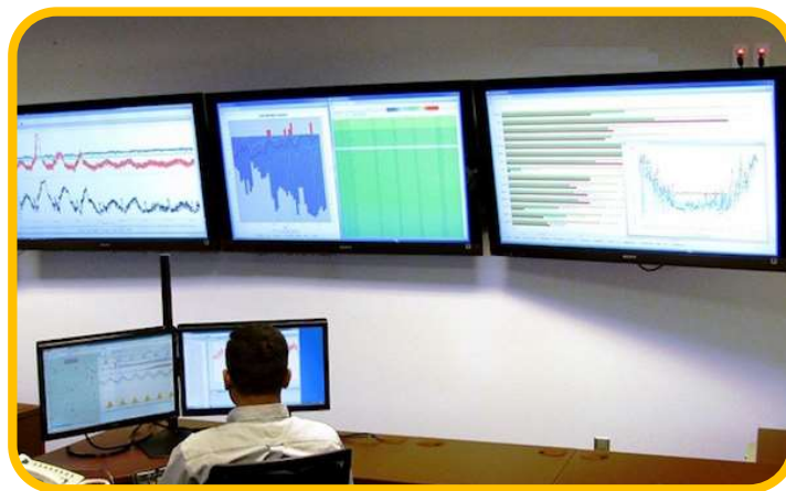
Monitorización de planta fotovoltaica
