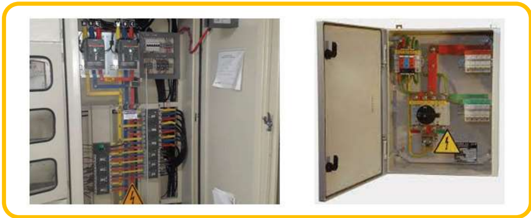
Cajas de agrupamiento fijadas a estructura de los paneles
