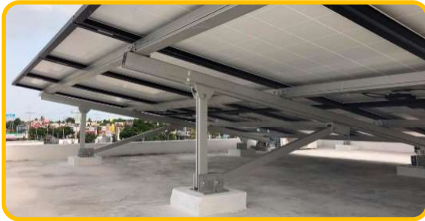
Estructura fija de paneles
