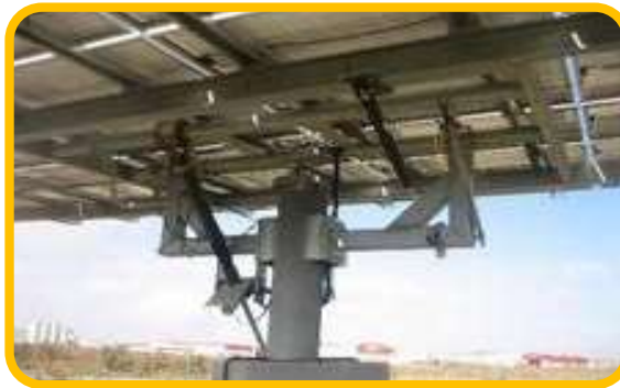
Estructura tipo mástil con seguidor solar
