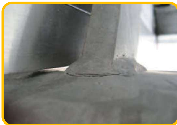
Posible rotura de fijación
